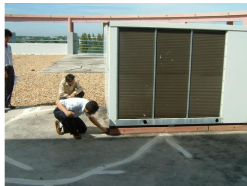
รูปที่ 1.2 รอยแตกร้าว และการใช้งานของพื้นชั้นดาดฟ้า
