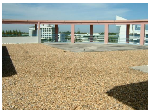
รูปที่ 1.1 สภาพหินกรวดที่โรยคลุมบนพื้นชั้นดาดฟ้า
